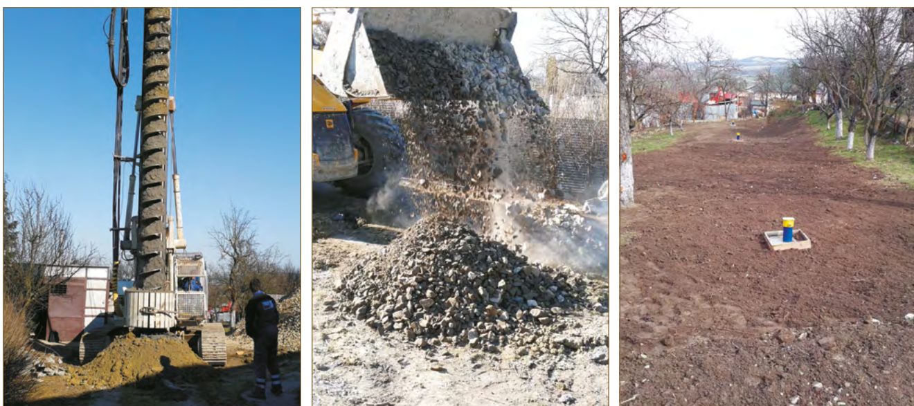
Obr. 8.62: Drenážna štrková stena – vľavo vrtanie štrkových pilót, v strede zásyp štrkodrvou, vpravo upravený povrch terénu so zabudovaným piezometrom (Laurenčík a kol., 2015)
