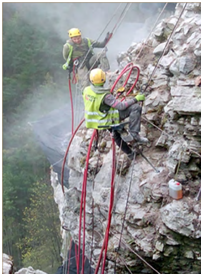
Obr. 11.53: Realizácia injektážnych vrtov do priemeru 93 mm a dĺžky 4 m na jednom z kritických skalných blokov pod hradom Strečno (Fekeč a kol., 2017)
