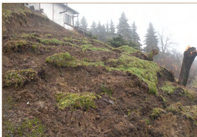
Obr. 8.18: Zosuvom porušený svah v meste Krupina (foto: V. Jánová)
