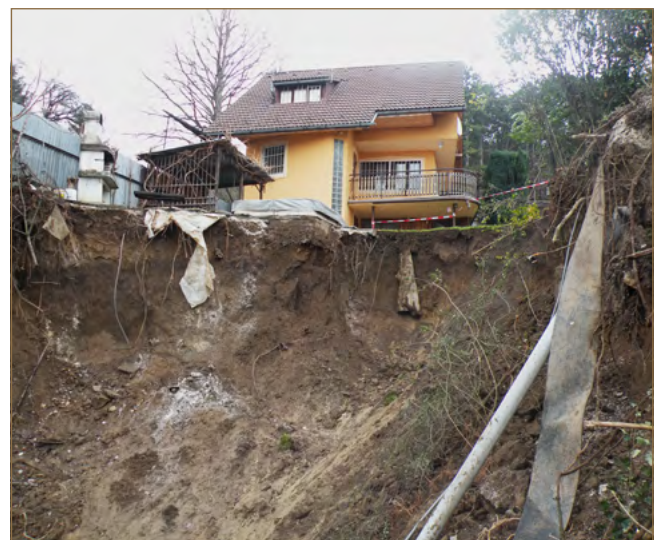
Obr. 4.12: Príklad zosuvu s rotačnou šmykovou plochou v obci Banka pri Piešťanoch (foto: V. Jánová)
