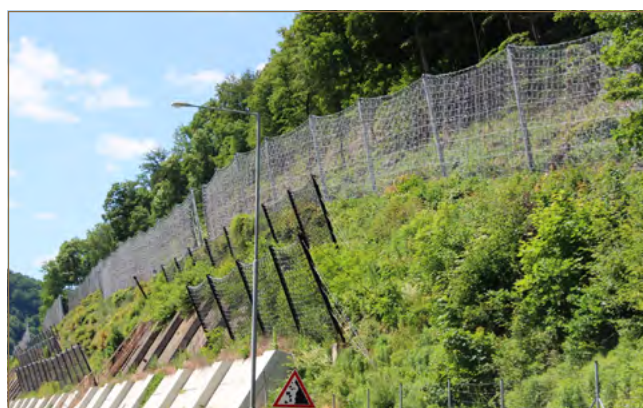
Obr. 11.65: Kombinácia dynamických bariér s obkladovými múrmi na ceste R2 v úseku Budča – Zvolen (foto: B. Prelovský)
