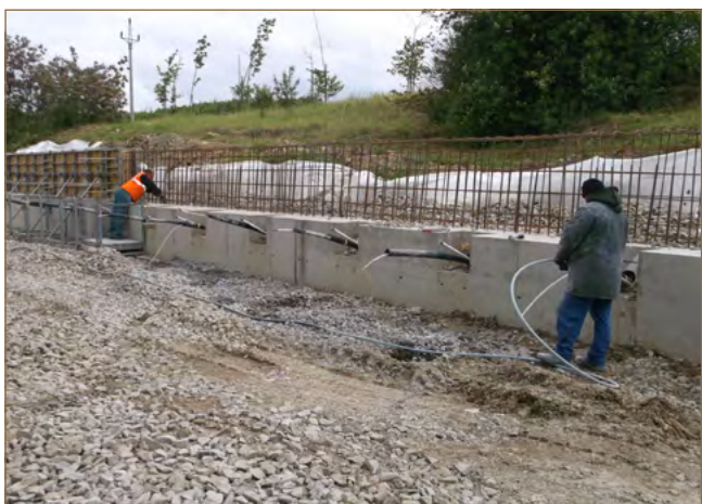
Obr. 11.32: Výstavba kotveného oporného múra v čele zosuvu v Nižnej Myšli nad základnou školou (foto: V. Jánová)
