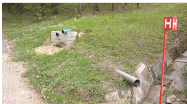
Obr. 11.10: Príklady spevnených odvodňovacích rigolov na zosuvoch Varhaňovce, Gribov, Kapušany a Nižná Myšľa (foto: V. Jánová)
