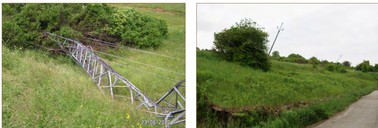
Obr. 9.9: Deštrukcia stožiara VVN v obci Dubovica (2010) a naklonené stĺpy elektrického vedenia v Nižnej Myšli (foto: P. Liščák, V. Jánová)
