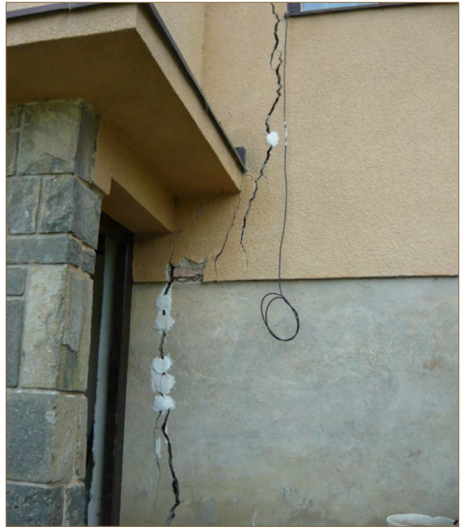
Obr. 8.40: Trhliny na rodinnom dome v Prešove na Horárskej ulici (foto: V. Jánová)
