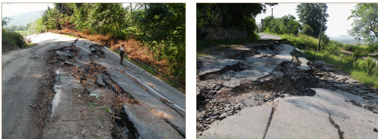
Obr. 9.8: Ukážky poškodených inžinierskych stavieb v obciach Miňovce a Nižná Myšľa (foto: V. Jánová)
