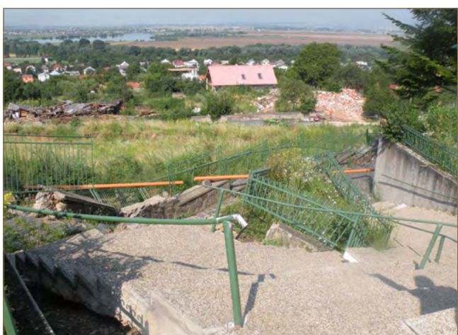
Obr. 8.5: Odľučnou hranou zosuvu porušené schody do kostola (foto: V. Jánová)
