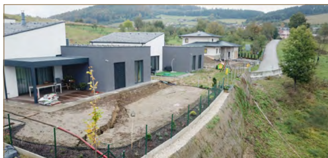
Obr. 3.12: Svahovou poruchou postihnutá umelá akumulácia na svahu v obci Ovčiarsko (foto: P. Fekeč)
