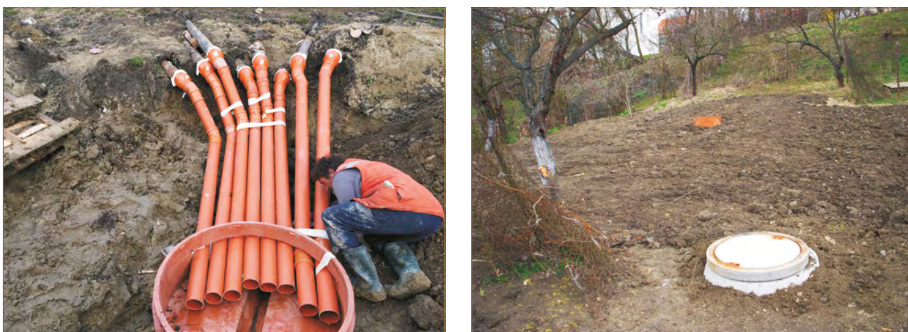
Obr. 8.63: Subhorizontálne odvodňovacie vrtý – vľavo zaústenie do zbernej šachty, vpravo povrchová úprava terénu v mieste zbernej šachty (Laurenčík a kol., 2015)
