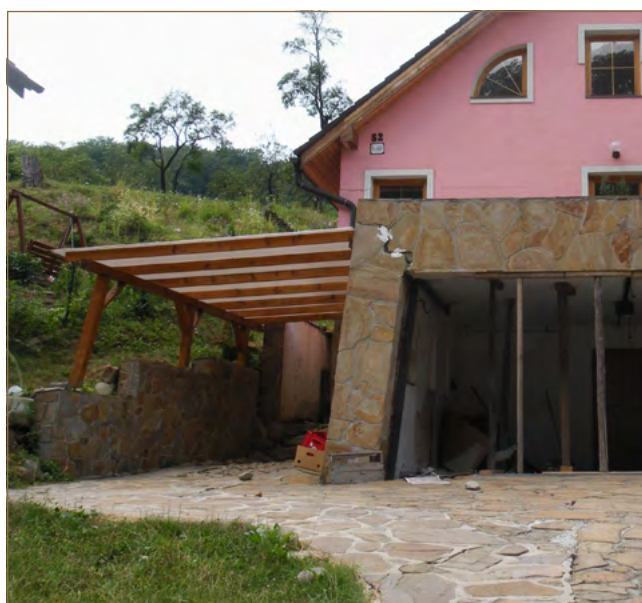
Obr. 8.39: Poškodený rodinný dom v Prešove na Horárskej ulici (foto: V. Jánová)
