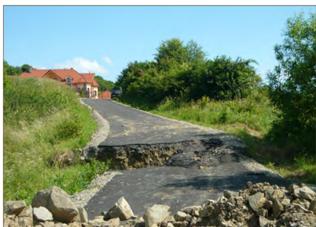
Obr. 8.25: Porušenie násypu a vozovky prístupovej cesty zosuvom v Kapušanoch (foto: V. Jánová)
