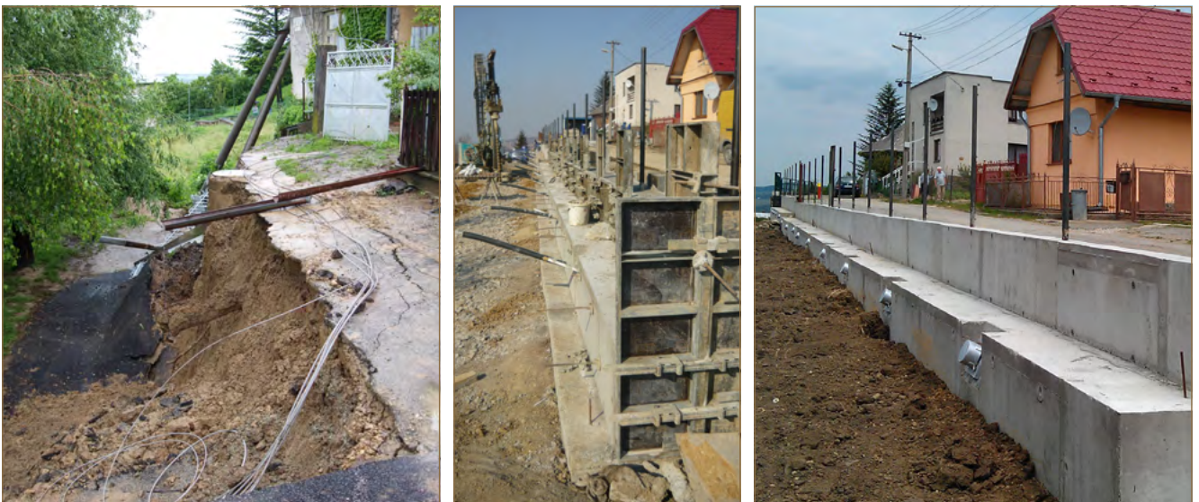
Obr. 8.54: Pohľad na odľučnú hranu zosuvu na ulici Malá Nemecká a na kotvenú železobetónovú stenu počas výstavby a pred ukončením sanácie (foto: L. Petro, V. Jánová, K. Házyová)
