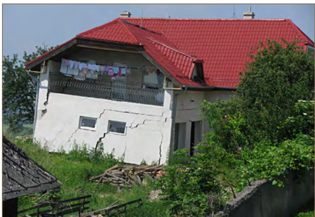
Obr. 8.3: Zosuvom porušený rodinný dom v Nižnej Myšli (foto: V. Jánová)
