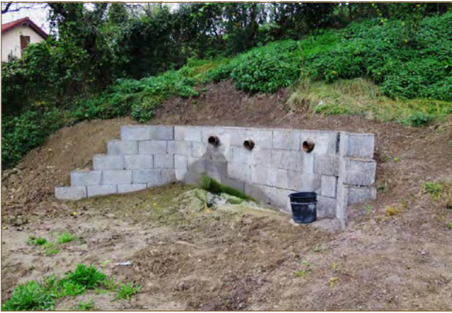
Obr. 8.33: Vyústenie subhorizontálnych odvodňovacích vrtov vo Vyšnej Hutke (foto: P. Fekeč)
