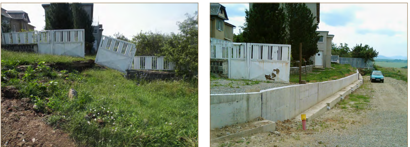
Obr. 8.55: Pohľad na Obchodnú ulicu pred sanáciou a po sanácii (foto: V. Jánová)
