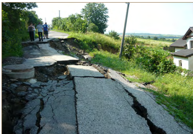
Obr. 8.4: Zosuvom porušená miestna komunikácia a elektrické vedenie (foto: V. Jánová)
