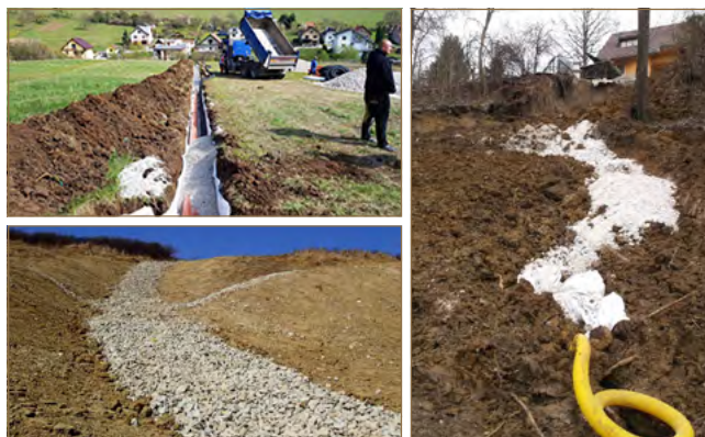
Obr. 11.23: Drenážne prvky na zosuvoch v Stránskom, Pečovskej Novej Vsi a v Banke (foto: J. Šimeková, K. Háziová)
