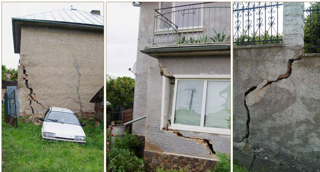
Obr. 9.7: Detaily poškodených objektov v Nižnej Myšli (foto: L. Petro)
