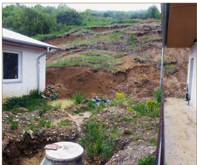
Obr. 3.10: Podrezanie svahu v obci Chmiňany pri výstavbe sociálnych bytov (foto: V. Jánová)
