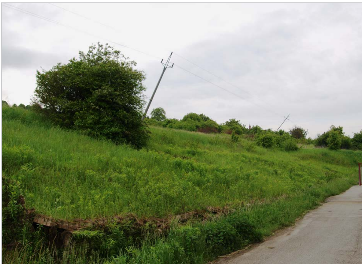
Obr. 39: Naklonené stĺpy elektrického vedenia na zosuve v Nižnej Myšli
