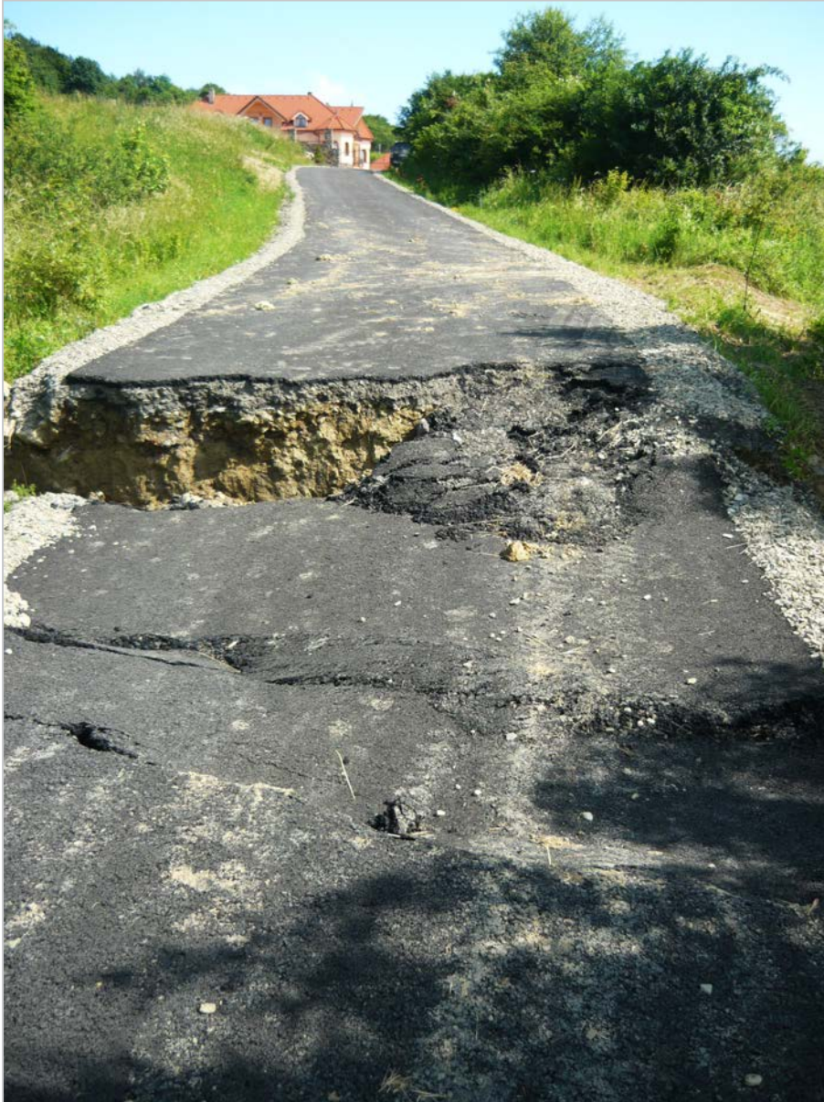
Obr. 78: Kapušany – porušená miestna komunikácia (2010)
