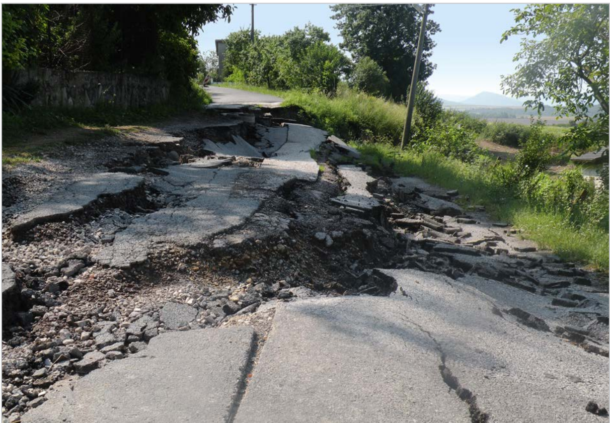
Obr. 23: Poškodená miestna komunikácia v Nižnej Myšli
