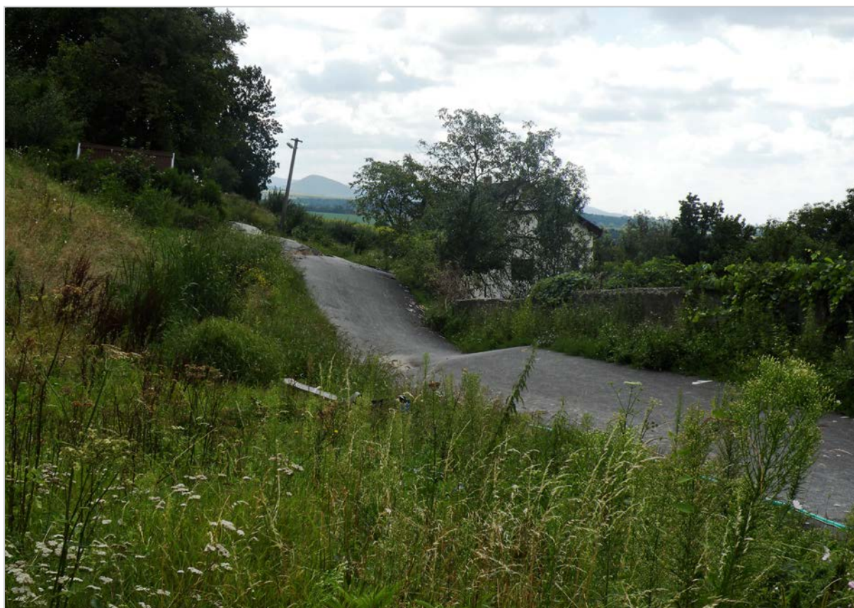
Obr. 19: Zvlnený povrch poškodenej cesty v Nižnej Myšli
