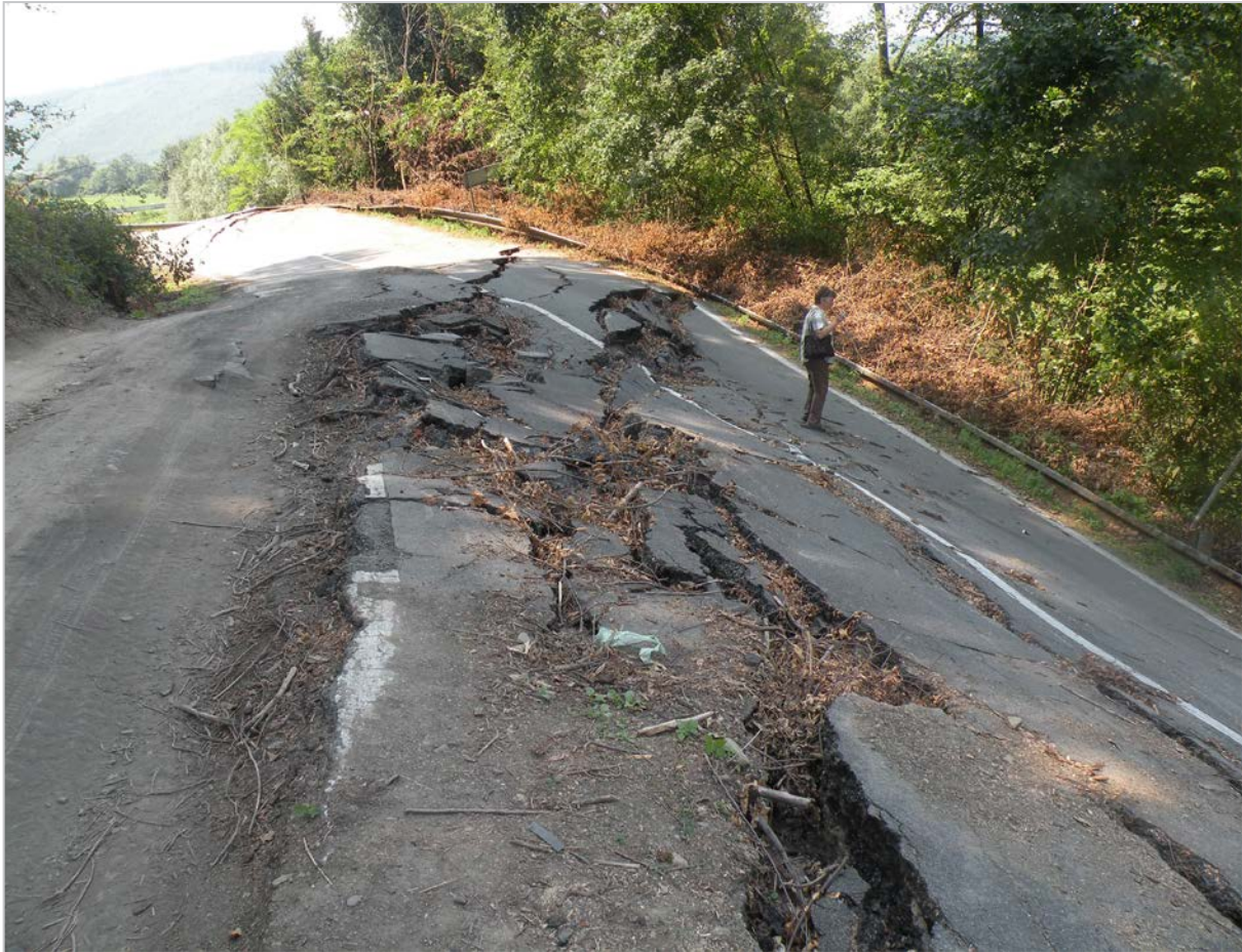
Obr. 24: Zosuvom poškodená cesta v obci Miňovce
