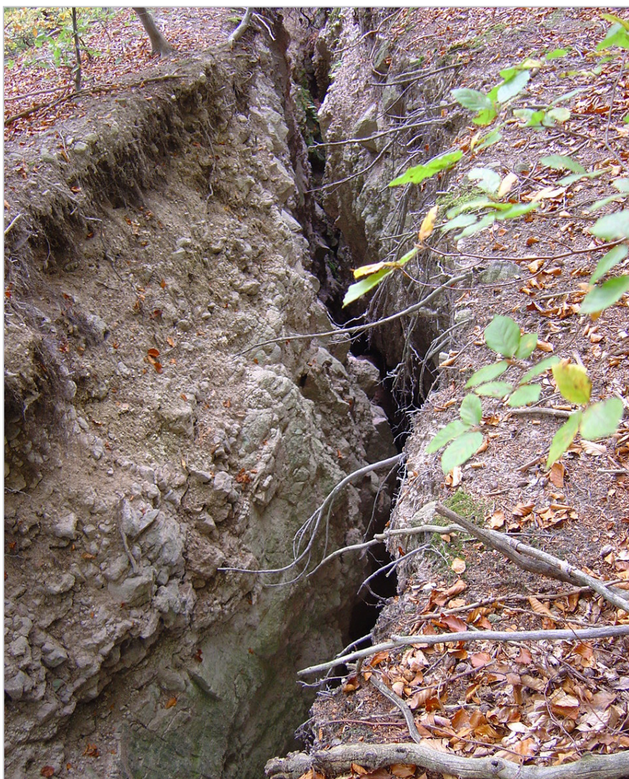
Obr. 36: Trhliny na svahoch Vtáčnika
