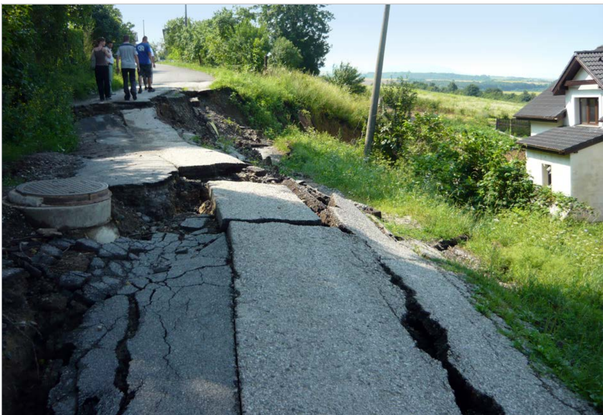
Obr. 88: Nižná Myšľa – poškodená komunikácia (2010)
