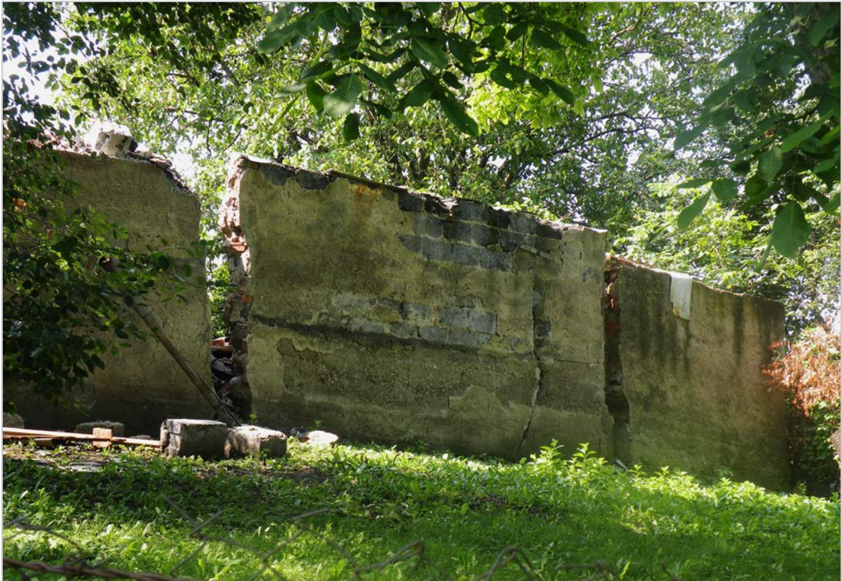
Obr. 22 a, b: Príklady rôznych trhlinami porušených objektov
