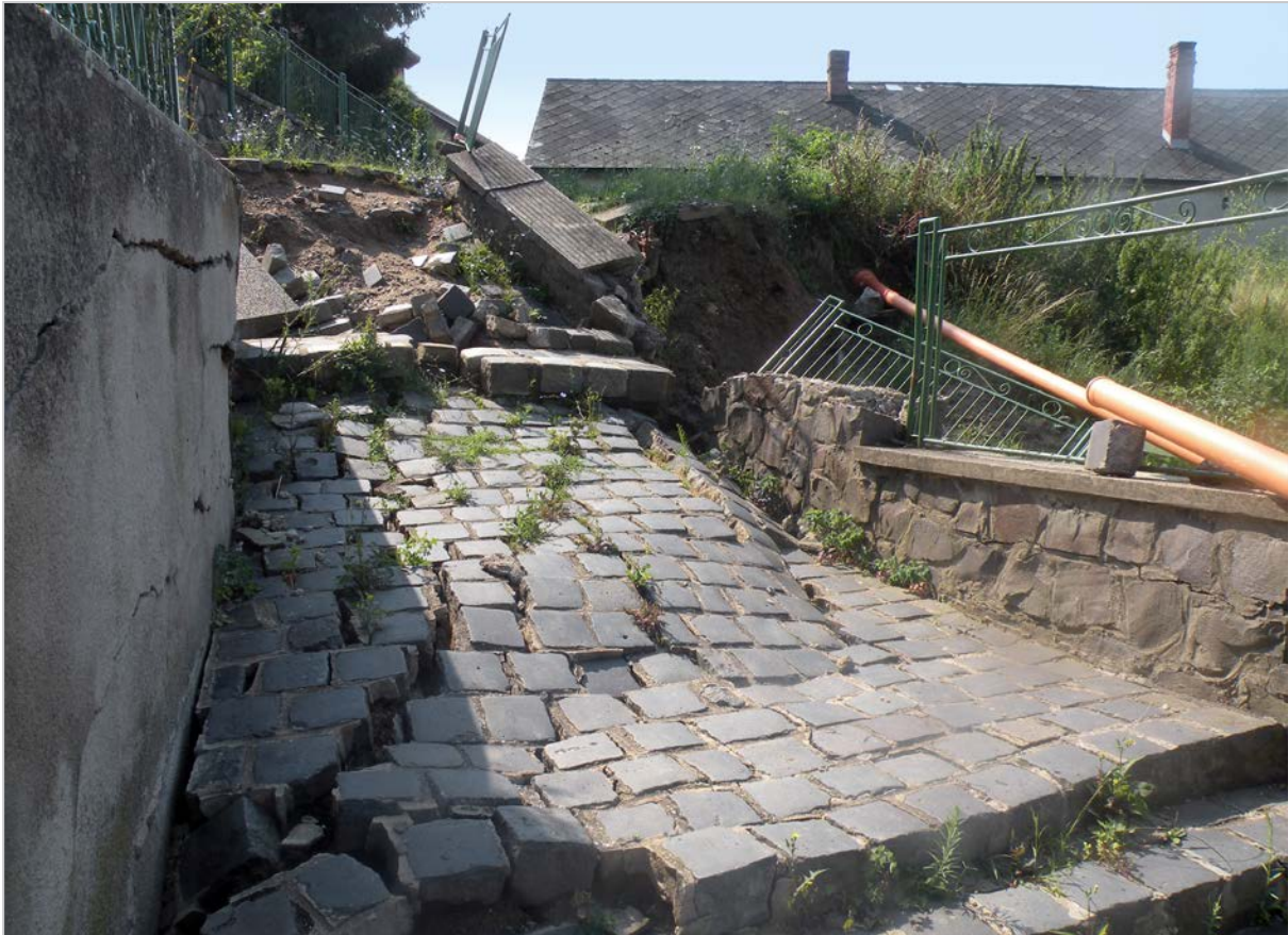
Obr. 87: Nižná Myšľa – odlučná hrana havarijného zosuvu pod kostolom (2010)
